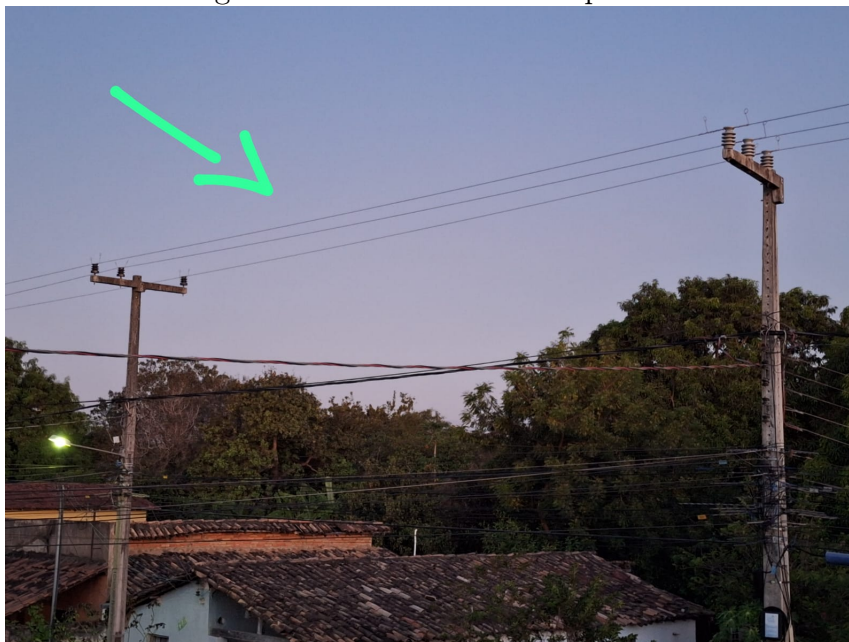
Figura 19: Rede Elétrica em postes
