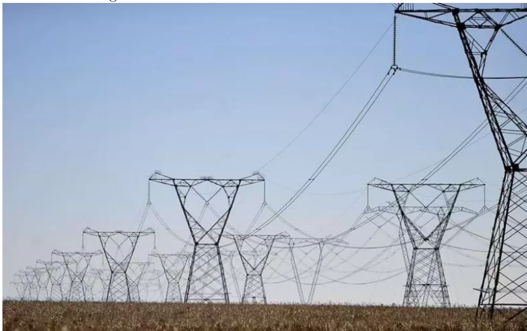
Figura 18: Rede Elétrica em Linha de Transmissão
